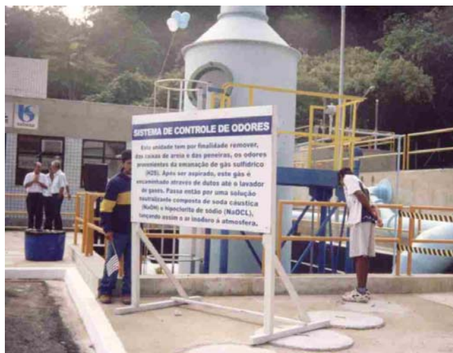
SISTEMA DE CONTROLE DE ODORES – H 2 S
