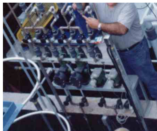
Dosagem automática de reagentes químicos
